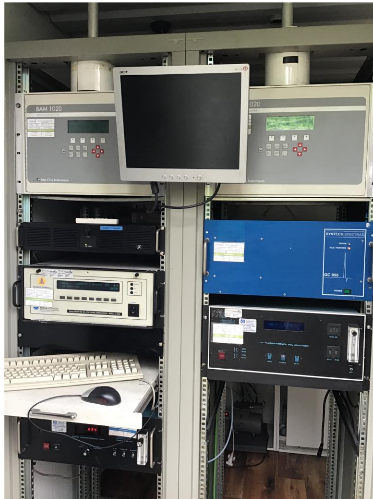
Figura 25. Equipos de medida instalados en la estación Constitución
