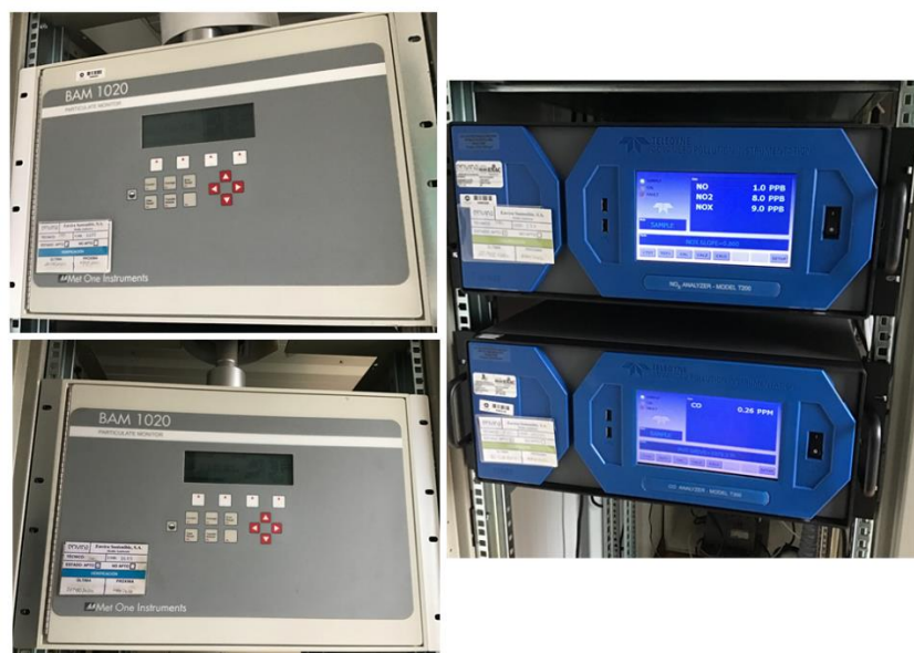
Figura 98. Equipos de medida instalados en la estación Santa Bárbara
