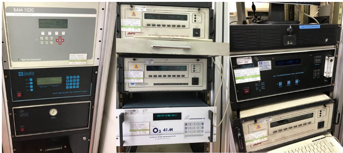
Figura 61. Equipos de medida instalados en la estación Hermanos Felgueroso
