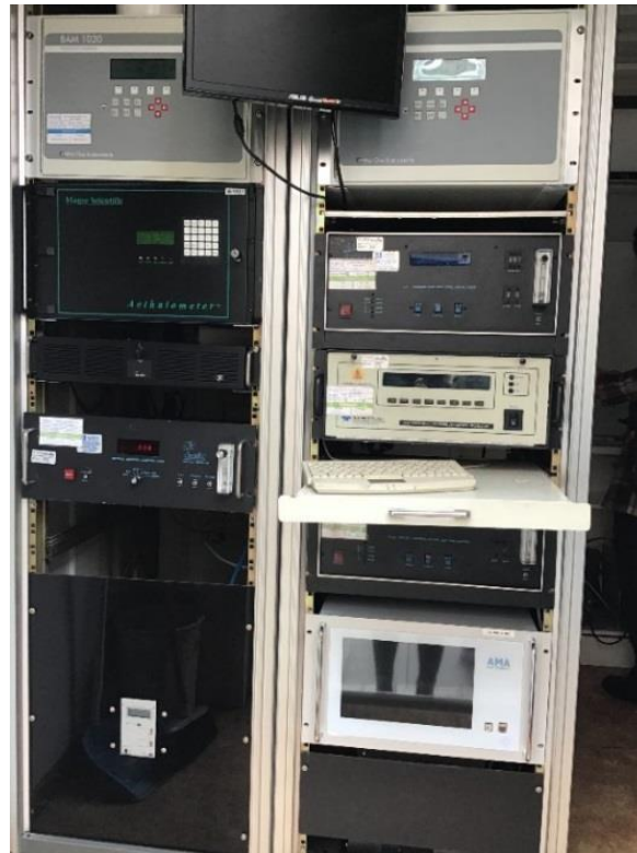
Figura 43. Equipos de medida de la calidad del Aire de la estación Argentina
