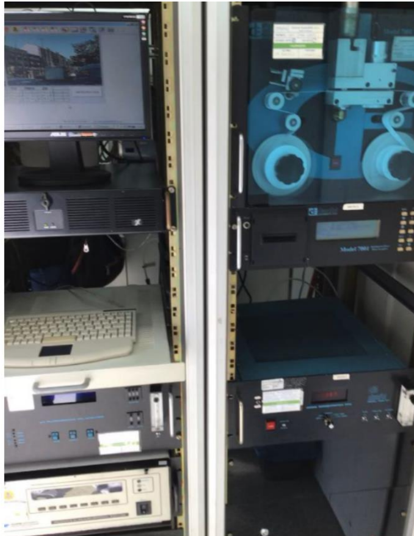
Figura 29. Equipos de medida instalados en la estación Plaza de Toros
