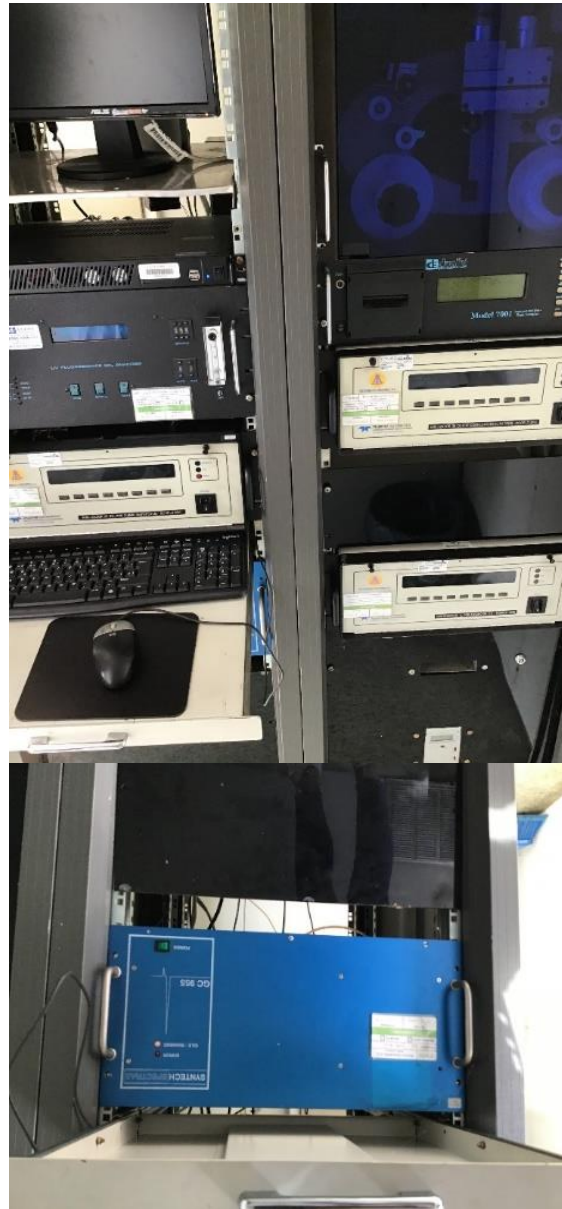
Figura 84. Equipos de medida instalados en la estación Trubia Piscinas
