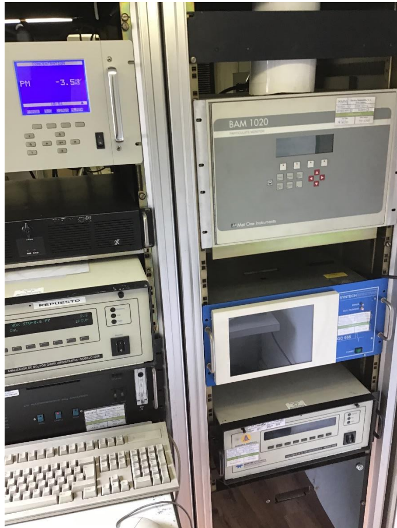
Figura 49. Equipos de medida instalados en la estación Palacio de Deportes
