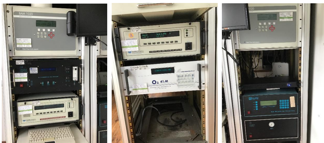
Figura 66. Equipos de medida instalados en la estación Purificación Tomás
