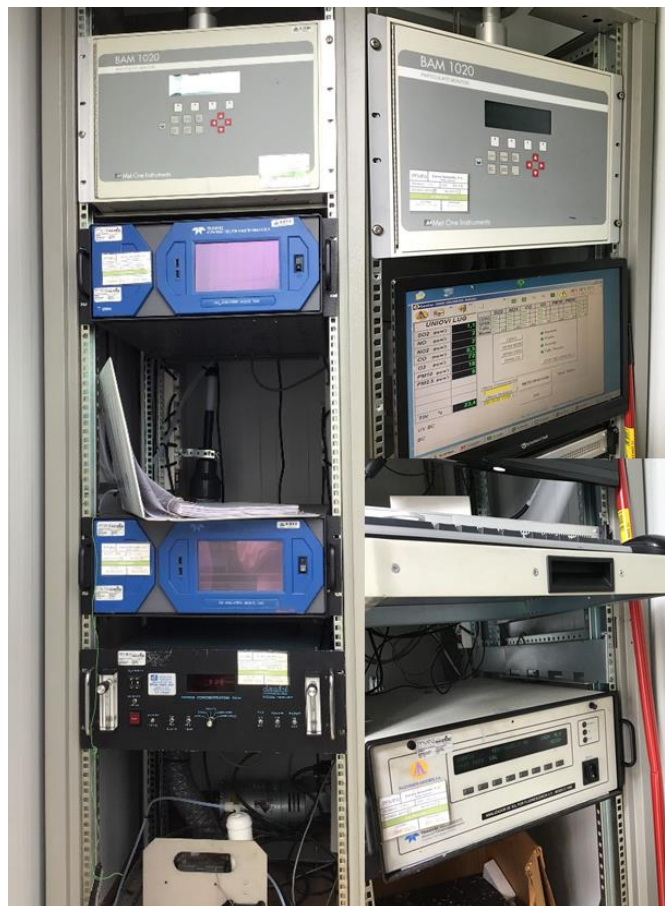
Figura 101. Equipos de medida instalados en la estación Lugones Instituto
